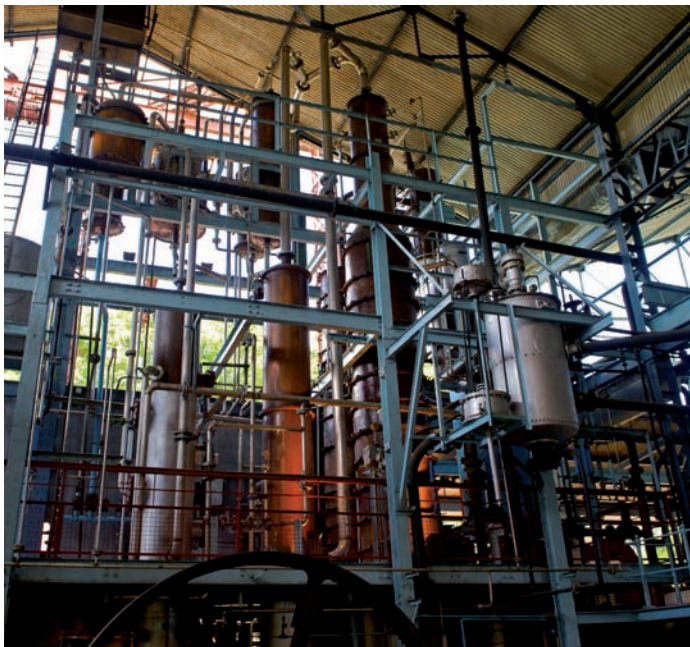
Les colonnes à distiller.
