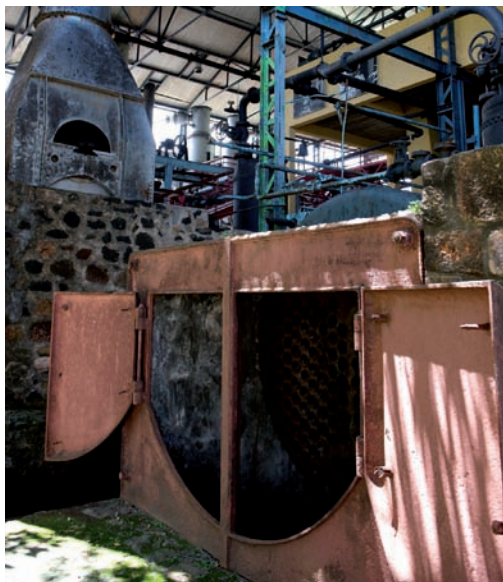
La chaudière à vapeur.
